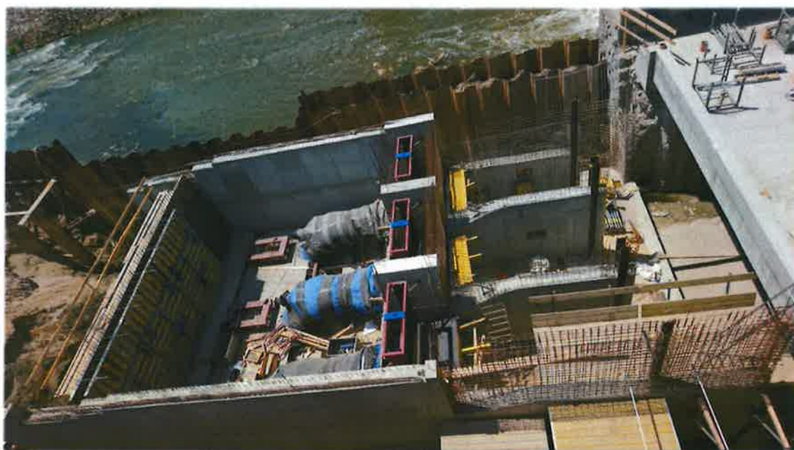
Malá vodná elektrárň Malé Krškany
