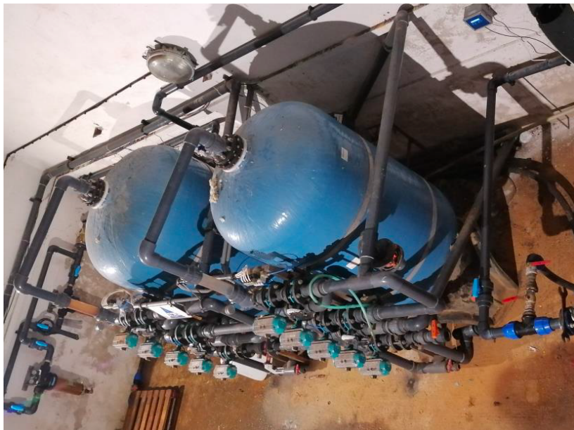
Úpravňa vody na pitné účely, Miesto: obec Štiavnické Bane Spustenie do prevádzky: 2023
