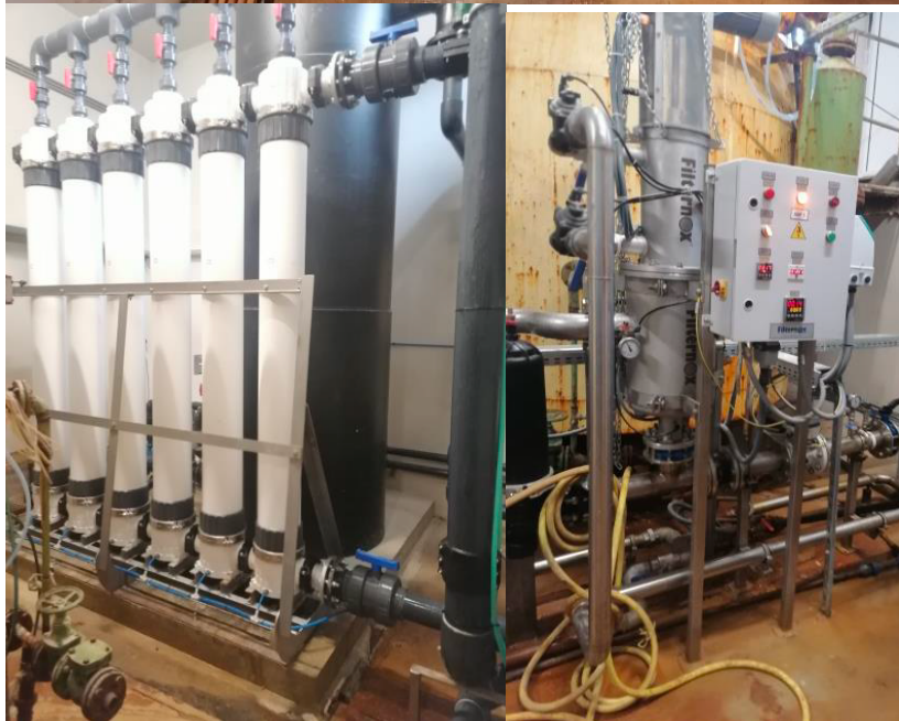
Úpravňa vody na pitné účely, Miesto: obec Zákamenné Spustenie do prevádzky: 2022
