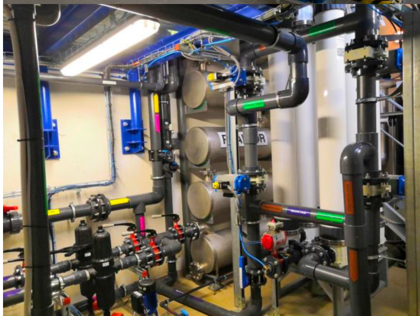
Úpravňa vody na pitné účely, Miesto: TVK, a.s., Selec Spustenie do prevádzky: 2019
