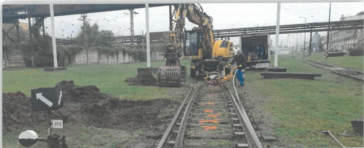
Výmena podvalov, podbitie koľají a výhybiek, sanácia podvalového podlažia, opravy rozchodov - Slovalco a.s. ŽnH
