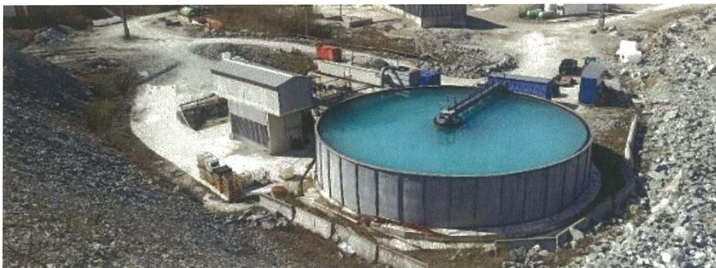
Mechanicko-chemická ČOV na východnom portáli tunela Višňové
