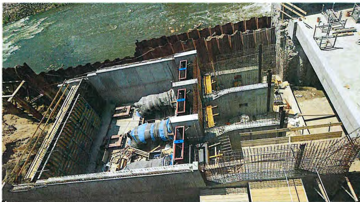
Malá vodná elektrárň Malé Krškany
